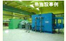
<他施設事例 蒸気タービン発電機>
